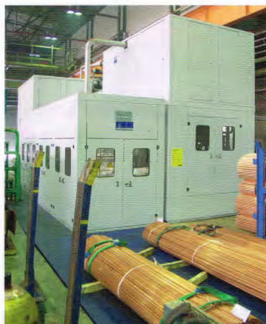
Die Medienaufbereitung mit Wärmerückgewinnung ermöglicht eine lange Standzeit des Lösemittels und einen energieeffizienten Betrieb der Anlage
